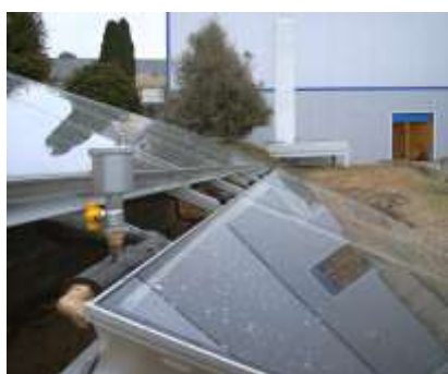
Les capteurs solaires
